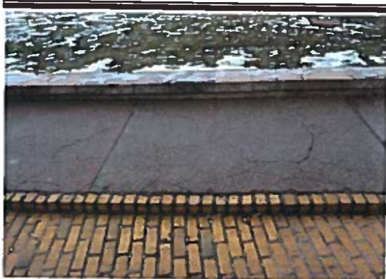
Foto 13. Dale trotuar cu fisuri multiple
