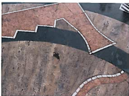
Foto 9. Placă de travertin cu defecțiune, fisuri elemente pavaj
