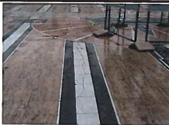
Foto 10. Fisură în plăcile de marmoră
