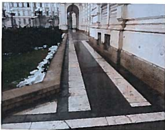
Foto 15. Trotuarul din fața clădirii cu multiple dale degradate
