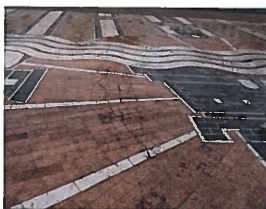
Foto 11. Fisuri multiple în elementele de pavaj (degradare totală)
