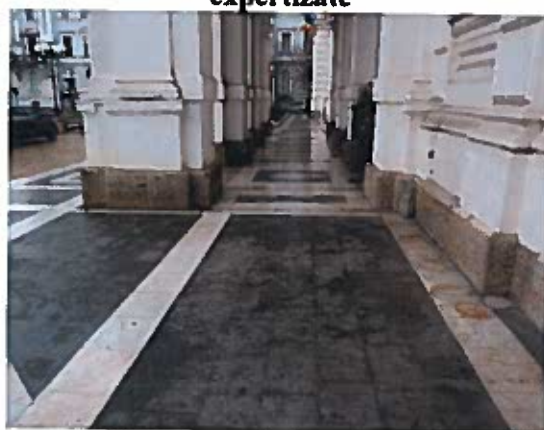
Foto 17. Trotuarul din fața clădirii cu multiple dale degradate
