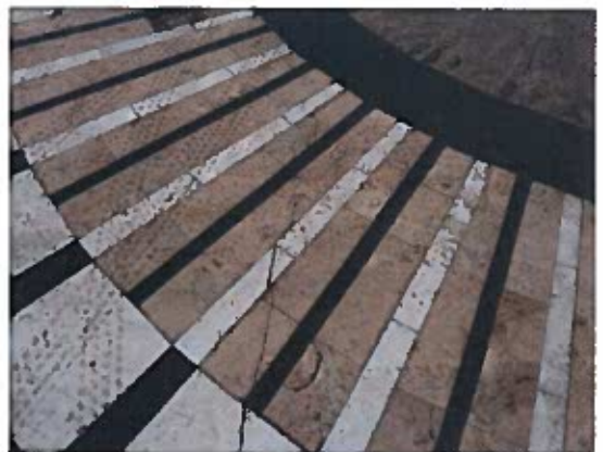
Foto 6. Elemente de pavaj fisurate
